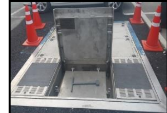
INVERTER-1 (전기차 충전기)
